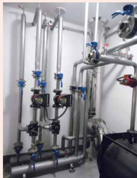
Fot. 3. Instalacja grzewcza z zaworami trójdrożnymi
