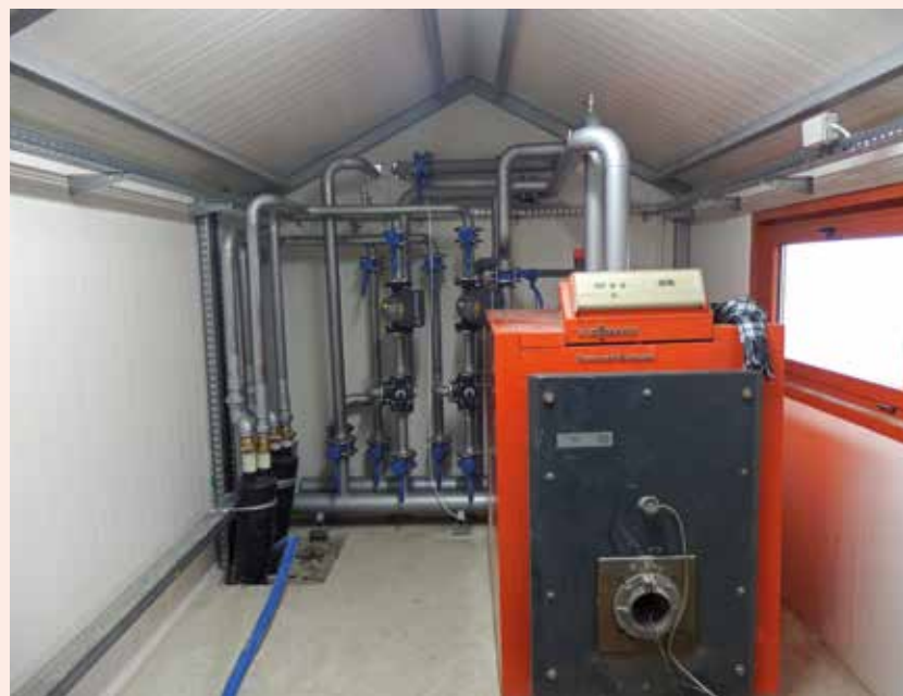
Fot. 2. Nowa kotłownia (na pierwszym planie kocioł gazowy)
